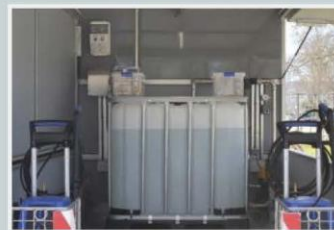
Vista de l'estació de desinfecció
