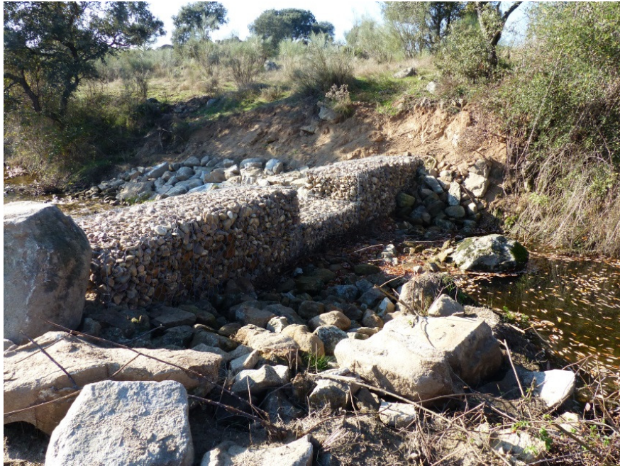
Figura 7: Azud de gaviones construido aguas arriba del tramo previsto tratar durante el segundo periodo, con caudal continuo
